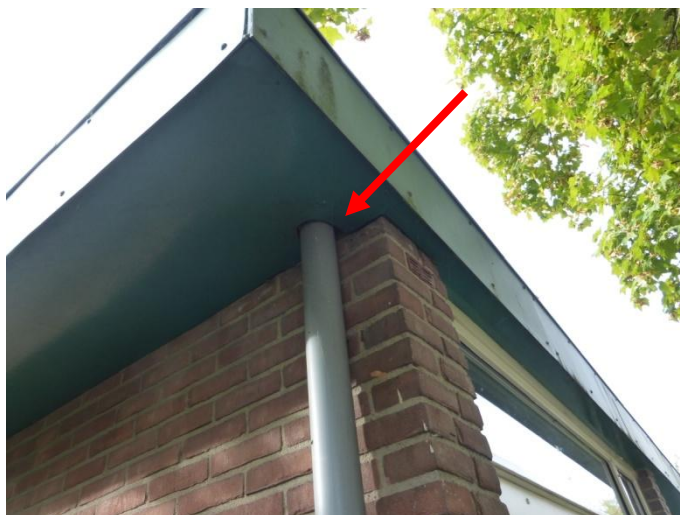
Foto 4: openingen bij de regenbuizen bieden mogelijk toegang tot de ruimte achter de boeiboorden.
