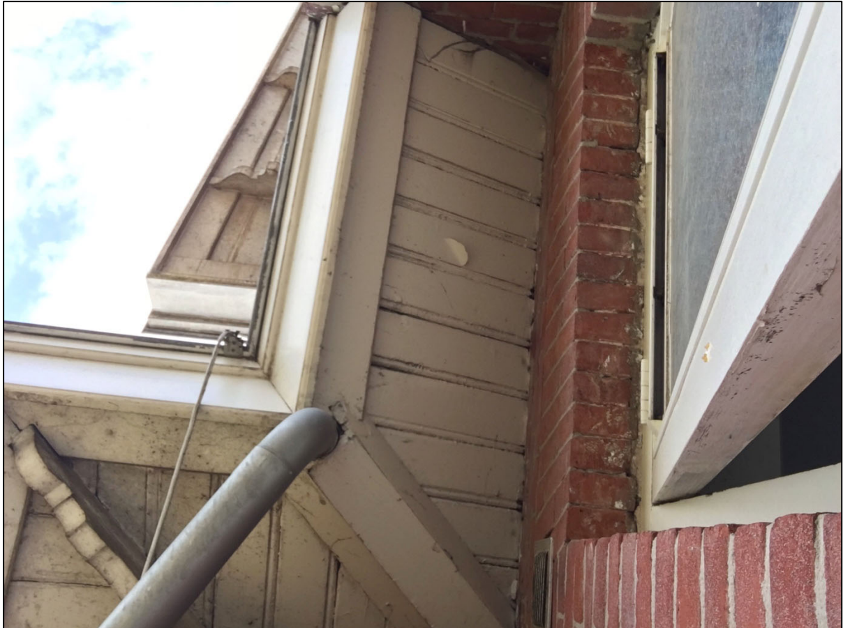
Afbeelding 8 Zijkant Strakke afwerking daklijst Schoudermantel 6 te Bunnik
