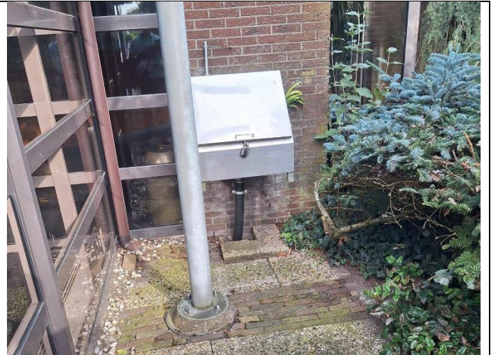
Foto 8: vulpunt opslagtank patio
