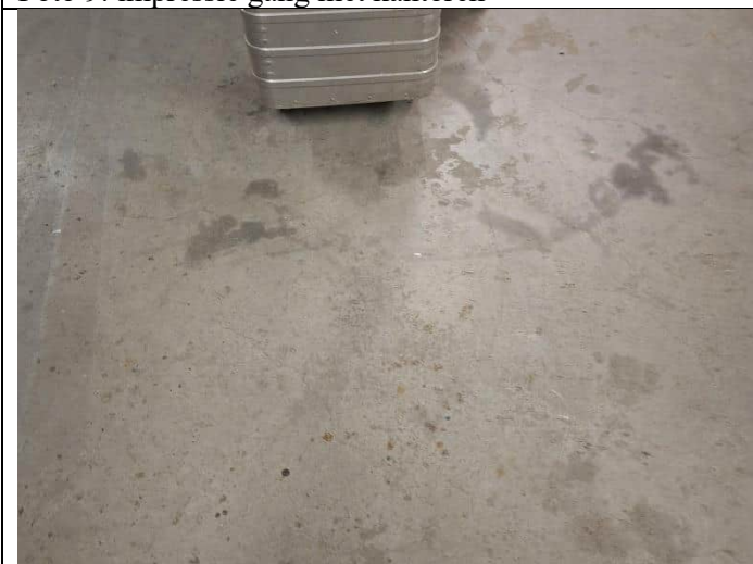
Foto 11: vochtvlekken op keldervloer
