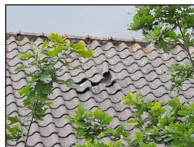
Figuur 27. Beschadigde dakpannen van woonhuis.
