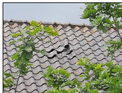
Figuur 17. Beschadigde dakpannen van woonhuis, geschikt als nestlocatie.
