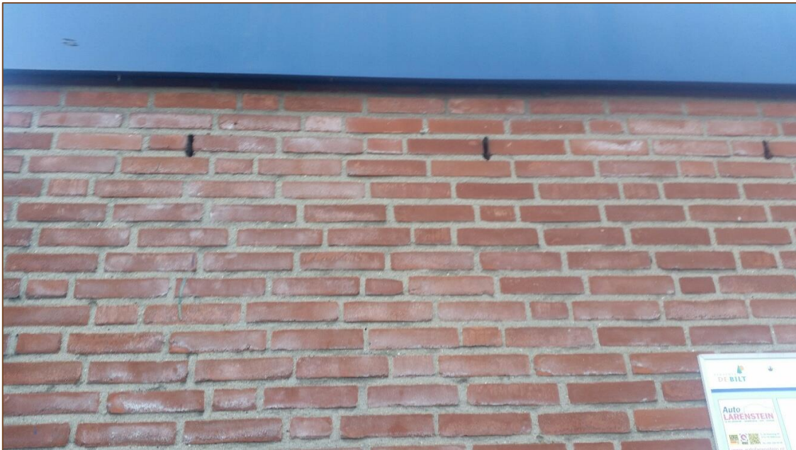
Figuur 5. Open stootvoegen in de gevels van het zwembadgebouw.
