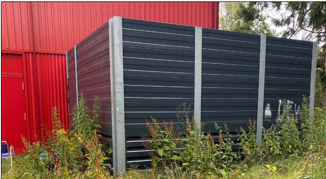
Geluidsscherm rondom de warmtepomp
