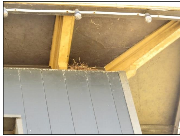
Figuur 12. Tweede vogelnest (niet in gebruik) onder de dakrand van de voorgevel van het oude deel (zie figuur 4).
