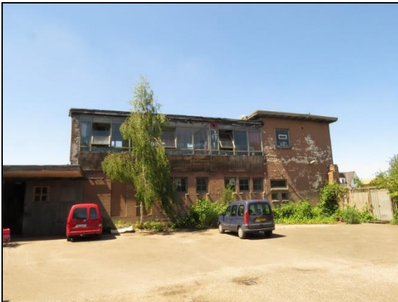
Figuur 13. Zicht op de opbouw met het kapotte dak.
