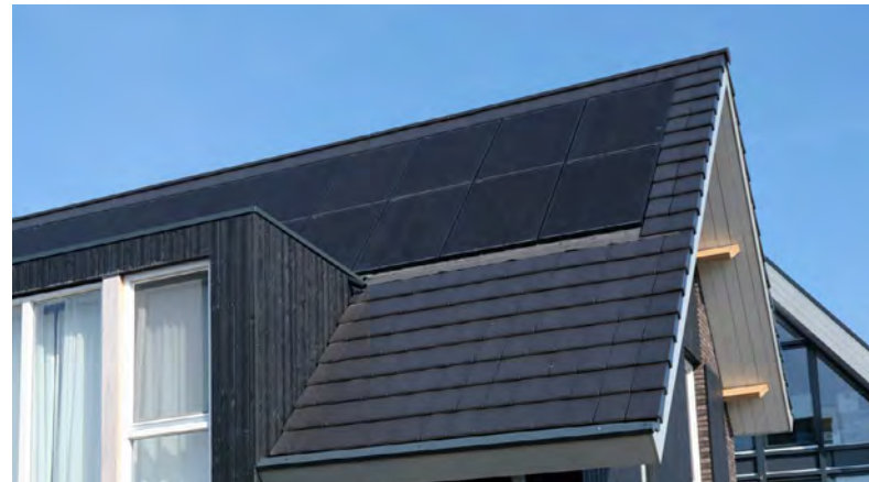
PV-panelen geïntegreerd in dakvlak
