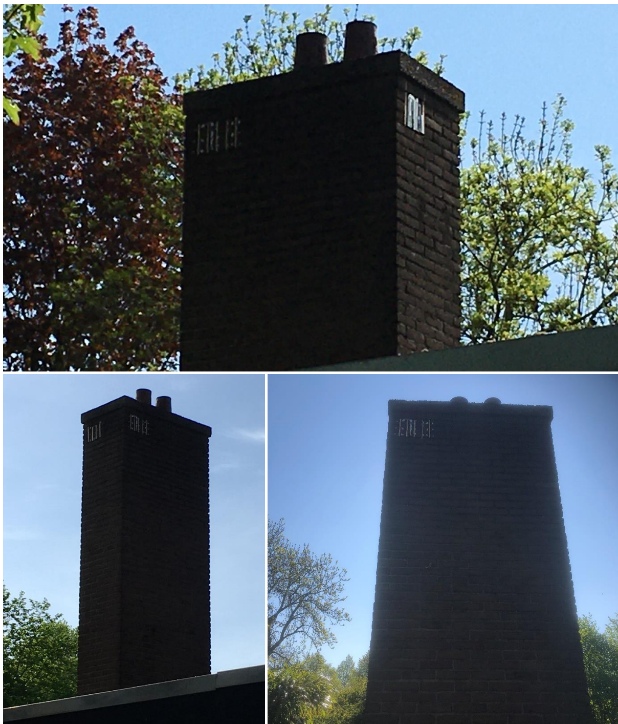
Figuur 2. Weergave van de schoorsteen waarbij de open stootvoegen nu geheel en definitief zijn gedicht, waardoor deze ontoegankelijk is voor vleermuizen. Opname: BBWS & Eelerwoude, 23 april 2020
