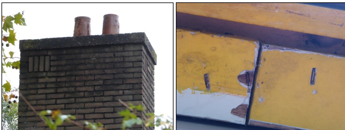
Figuur 2. Links: Schoorsteen met ventilatievoegen. Rechts: openingen dakbeschot
