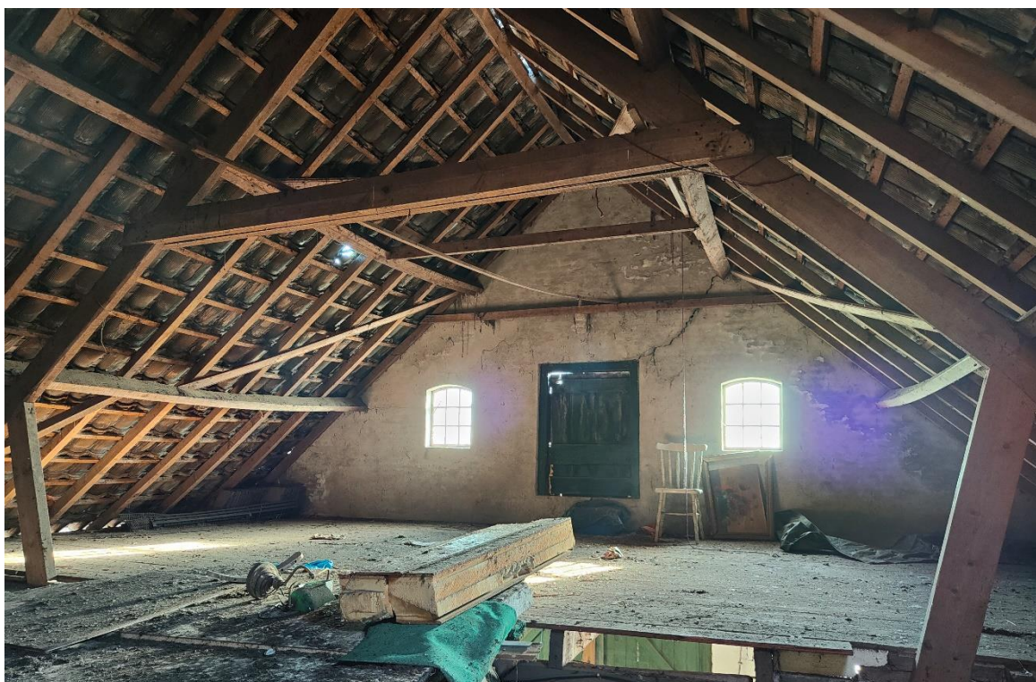
Figuur 2 De schuur beschikt niet over dakbeschoot, waardoor een geschikte dakruimte voor vleermuizen ontbreekt.
