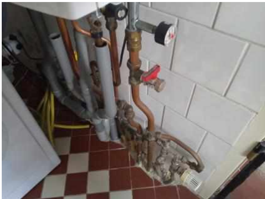
onverdacht leidingwerk woonhuizen
