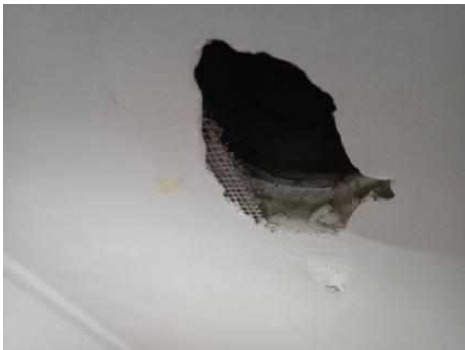
onverdachte ontluchting woonhuizen
