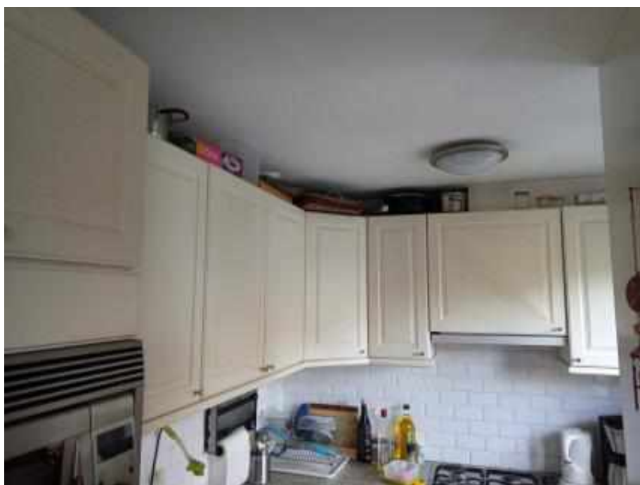
onverdacht plafond keuken woonhuizen
