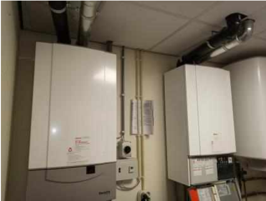
onverdachte cv-ketels in bedrijfspanen
