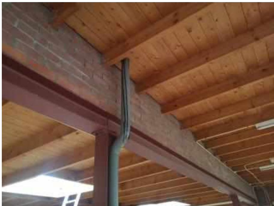
PVC afvoeren bedrijfspand Eemstraat 14
