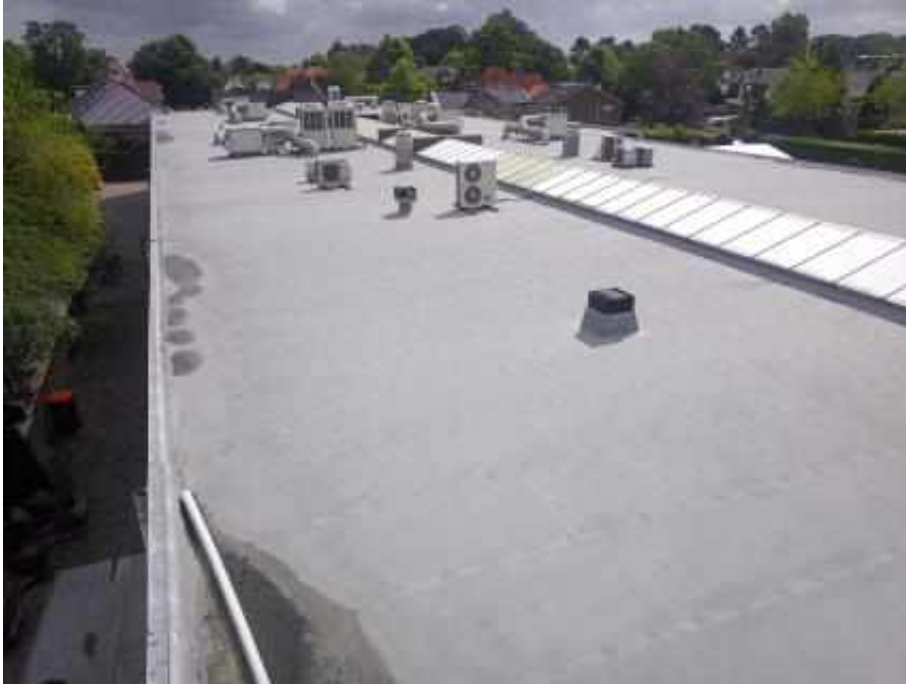
onverdacht dak bedrijfspand Schoolstraat 53
