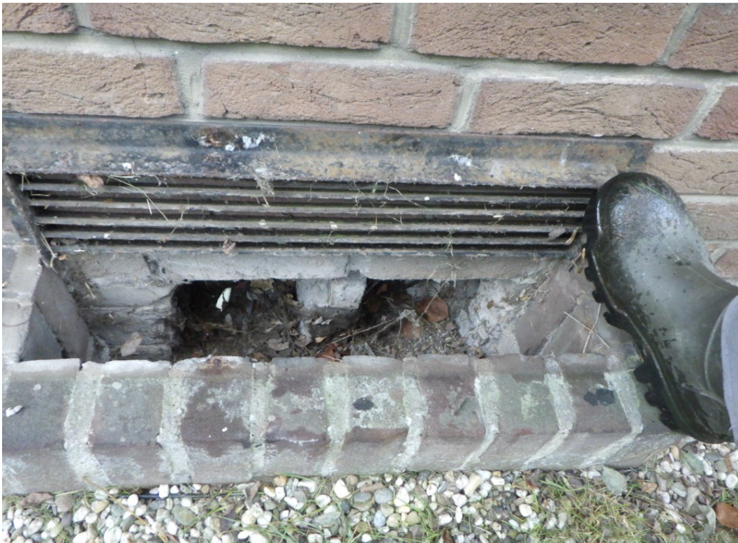
Figuur 7: Ventilatiekanaal langs de buitenmuren.
