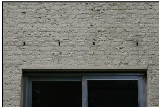
Afbeelding 6: Openstootvoegen in spouwmuur
