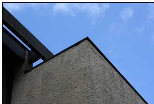
Afbeelding 4: Openingen onder de dakranden
