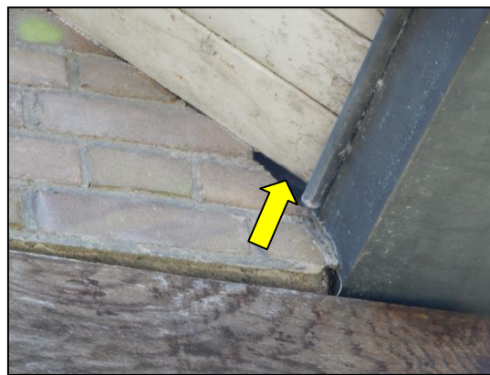
Figuur 11. Gat in muurdeel woning.
