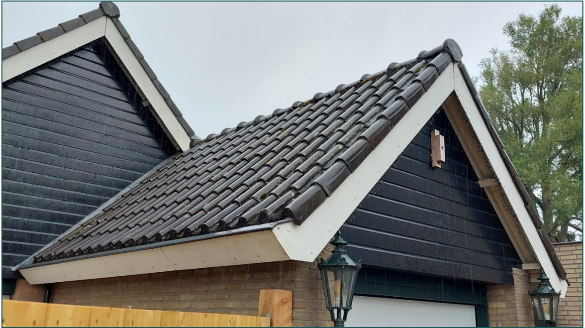
Figuur 3 De daken, gevelbetimmeringen en gevels sluiten allemaal nauw op elkaar aan, hierdoor is geen sprake van geschikte invliegopeningen.
