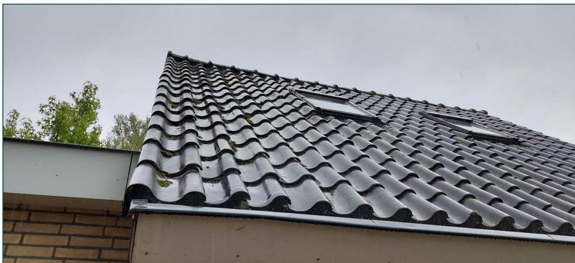
Figuur 3.2 Weergave van het dak van de garage met zichtbaar dakpannen welke de dakvoet afsluiten.
