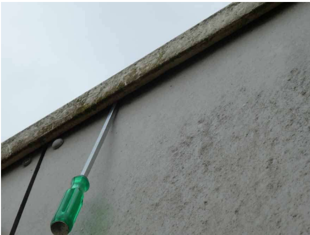
Figuur 15 Geen ruimte tussen daklijst en Tresaplaat
