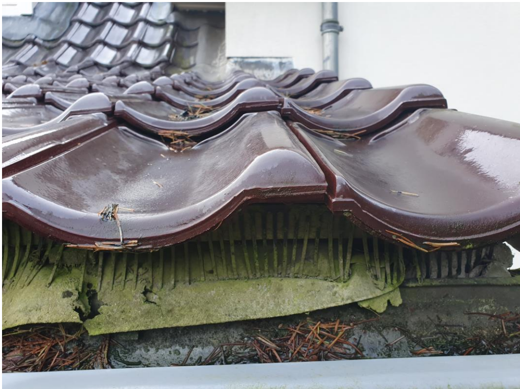
Figuur 4 Het vogelschroot in de goot maakt het onmogelijk voor huismussen om nestgelegenheid te vinden onder het dak.
