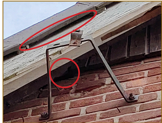
Afbeelding 5: In de achtergevel zijn mogelijke toegangsoeningen voor vleermuizen aanwezig, o.a. in de vorm van een gat in de gevel en ruimte onder kantpannen.
