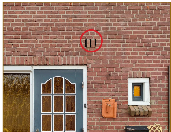
Afbeelding 7: In de achtergevel zijn mogelijke toegangsoeningen voor vleermuizen aanwezig, o.a. in de vorm van ventilatievoegen.
