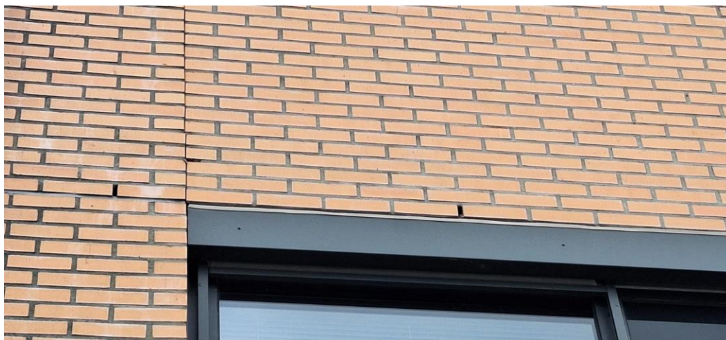
Figuur 6: Open stootvoegen Plotterweg 38 Amersfoort (Laneco, 2024).
