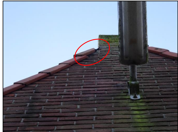
Fig. 2.9 Gat bij kantpan opstal 2 (bron: FF Solutions)
