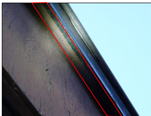
Fig. 2.5 Spleet boven garagedeur opstal 1, kort boeideel en plafond binnenzijde garage direct zichtbaar (bron: FF Solutions)
