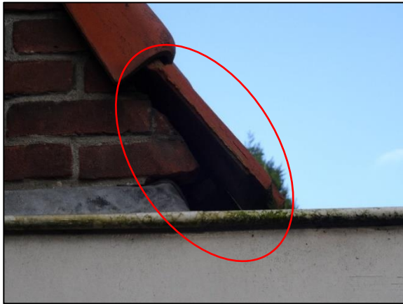
Fig. 2.8 Gat bij kantpan opstal 2 (bron: FF Solutions)
