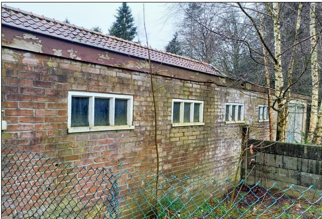
Figuur 3: halfvergaan metsel- en houtwerk dat hersteld moet worden.
