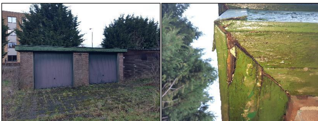
Figuur 4.2 Het te slopen bijgebouw (links) en een detail van de opening ontstaan door lekkage (rechts). Het gebouw is ongeschikt voor vleermuizen. Foto's: Ecogroen, 2023.
