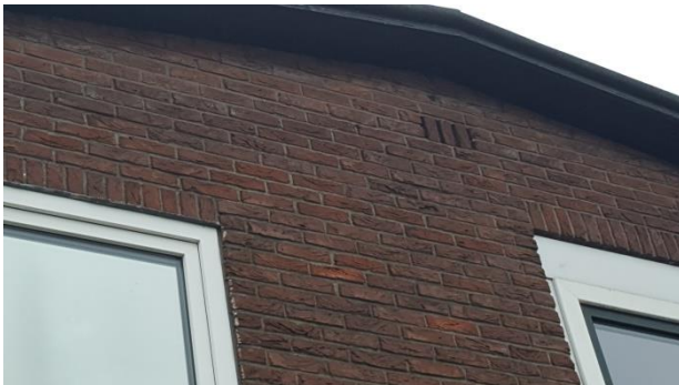
Afbeelding 5.1 | Open stootvoeg in de woning
