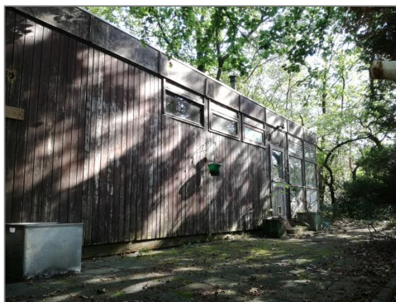
Afbeelding 2.4 | Vervallen woning op het perceel van de manege
