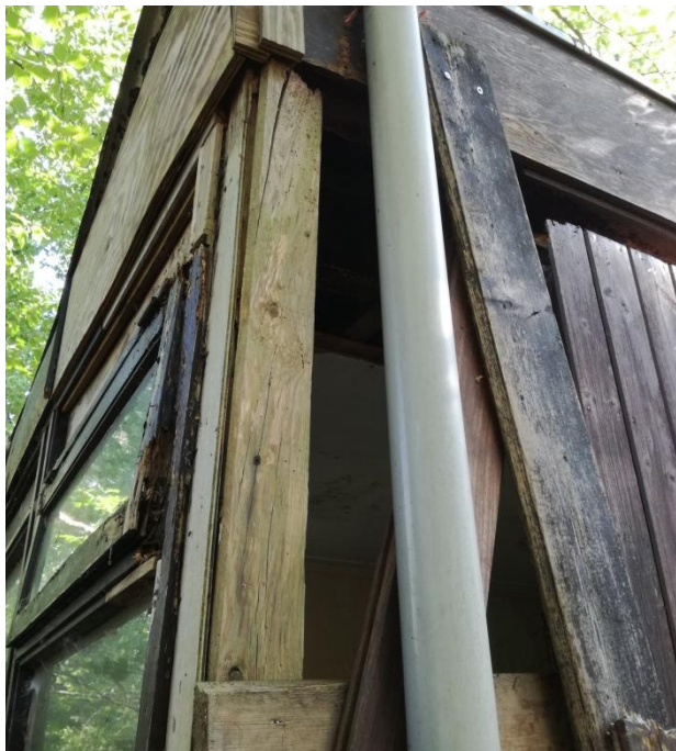
Afbeelding 5.1 | Gebouwen verkeren in slechte staat; op veel plekken zijn openingen waar dieren zoals vleermuizen toegang kunnen vinden tot verblijfplaatsen
