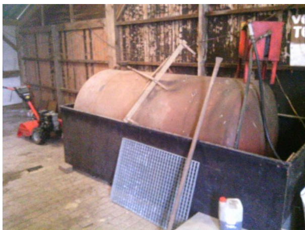
Foto 1: bovengrondse tank in lekbak.
