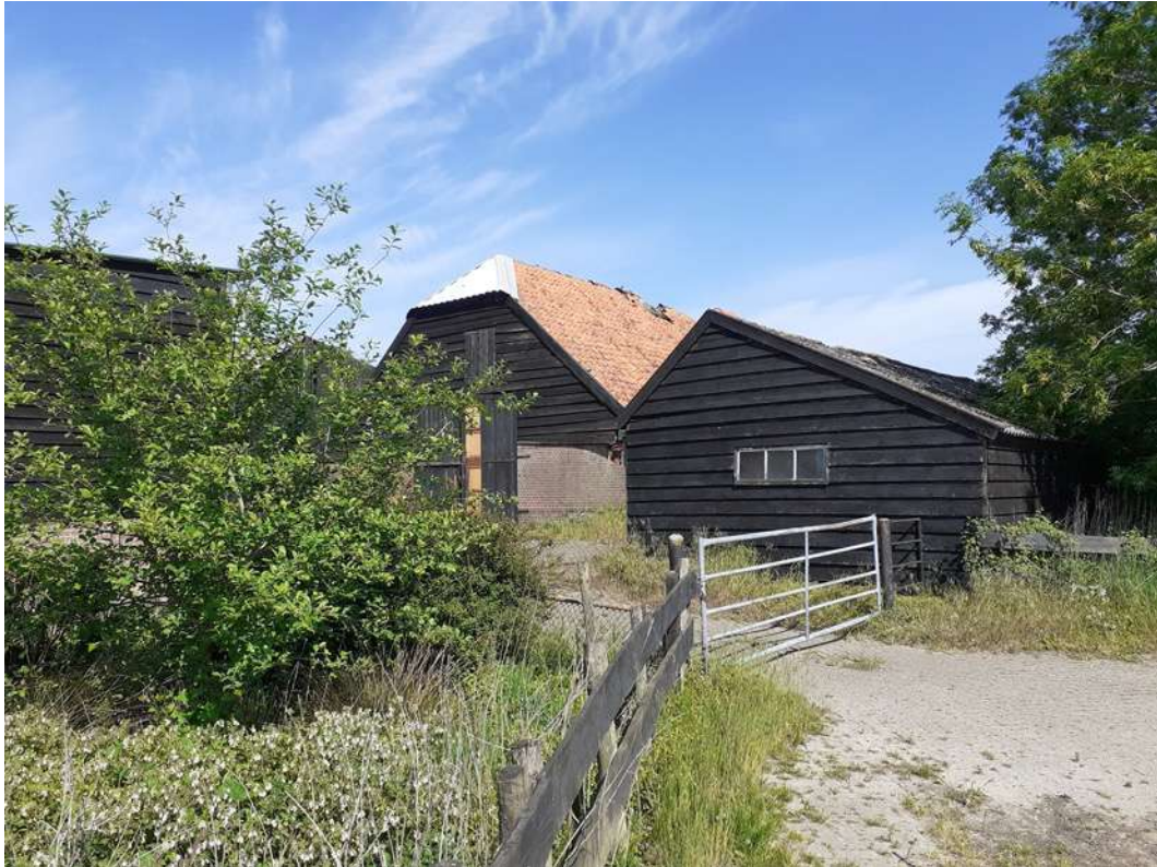
Figuur 5.2 Deels ingestorte schuur met rode dakpannen langs de Achterhoekerweg 3/3a.
