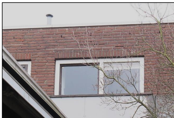
Foto 6. Open stootvoegen boven ramen van appartementen
