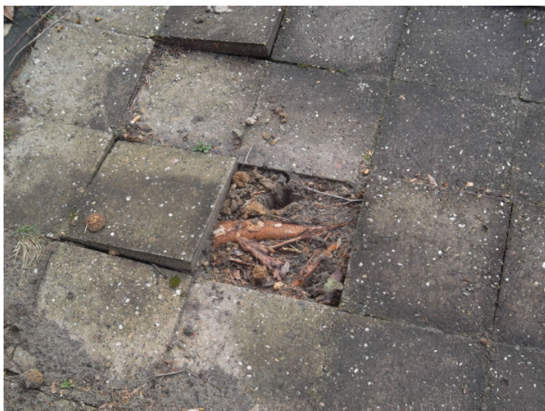
Oppervlakkige wortels van boom 99299 die de tegels opdrukken.
