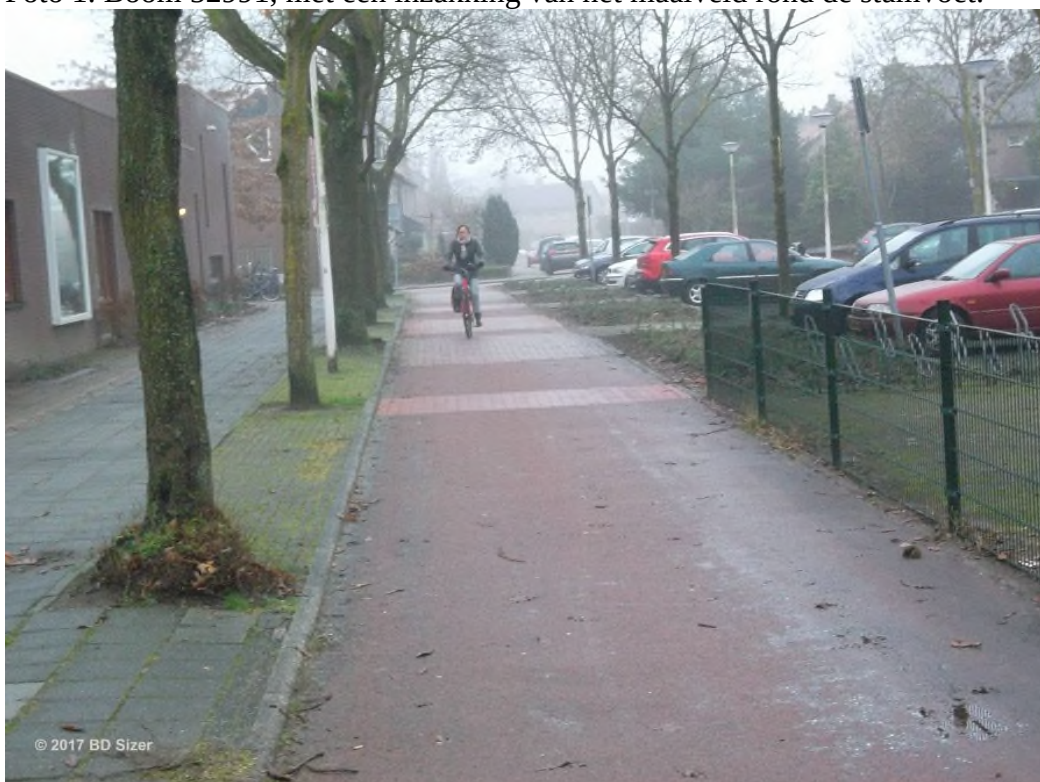
Foto 2. Links 52997. Op deze foto is duidelijk te zien dat enkel de bomen die aan de overzijde van het fietspad een (voedzame) heesterstrook hebben liggen met hun wortels het fietspad hebben opgedrukt. De voorste boom is ook beduidend kleine/dunner dan de overige bomen (uitgezonderd 52991, die in 2005 herplant is). Gezien vanuit het oosten.
