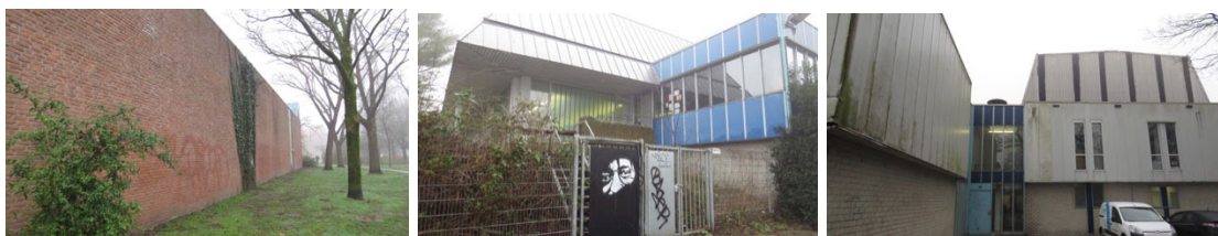
Figuur 4. De rode muur (links) is van boven strak afgewerkt met een metalen strip. Ook overige gebouwstructuren zijn ontoegankelijk / ongeschikt voor vleermuizen en gebouwbewonende vogels.
