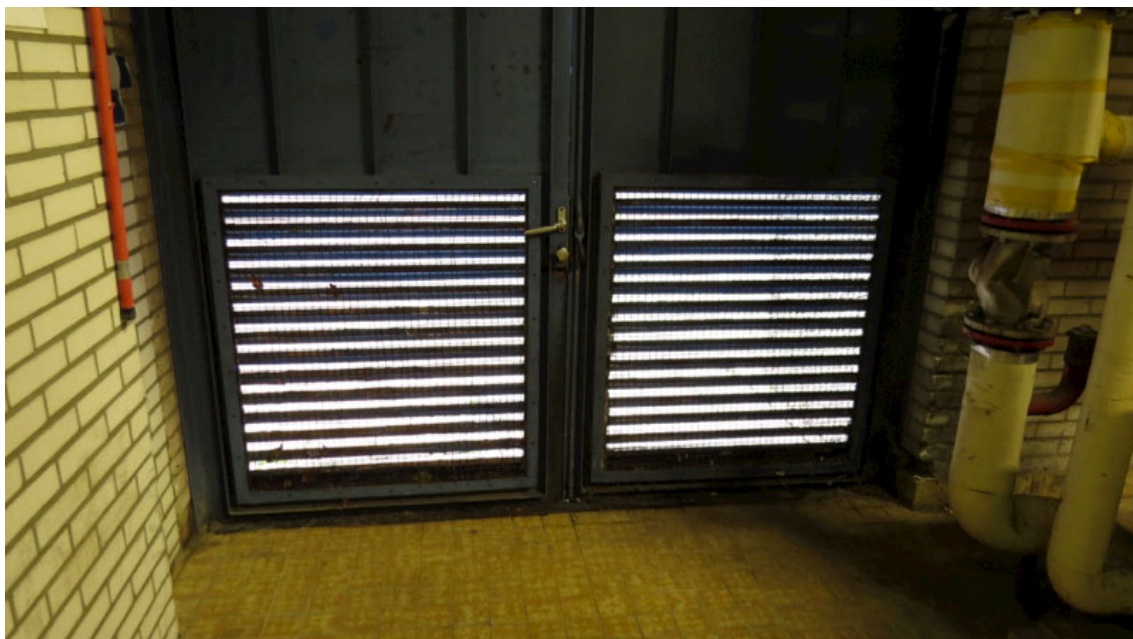
Figuur 3. De ventilatieroosters vormen het enige contact met de buitenlucht in de machinekamer.
