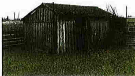
Schuur met asbest verdacht dak en wanden Bernhardstraat 40
