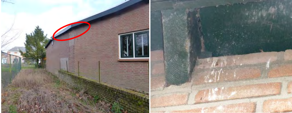
Figuur 7. Aangetroffen gat aan de westzijde van het gebouw in het plangebied. De locatie biedt een potentieel geschikte broedlocatie voor de in de omgeving voorkomende huismus.
