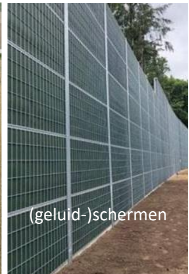
inrichting van het naastgelegen trafostation
