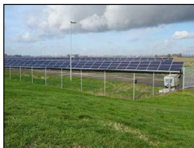
Figuur 5. Zonnepanelen in het noordelijk deel van de onderzoekslocatie.
