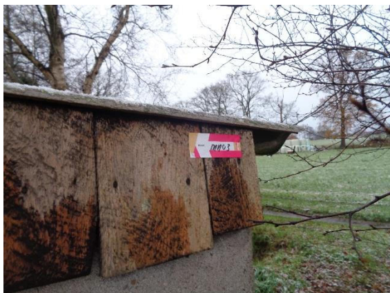
Monsternamelocatie MA03 (asbest aantoonbaar)
