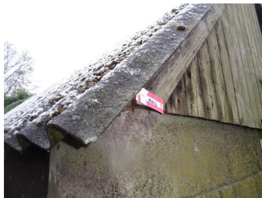
Monsternamelocatie MA04 (asbest aantoonbaar)
