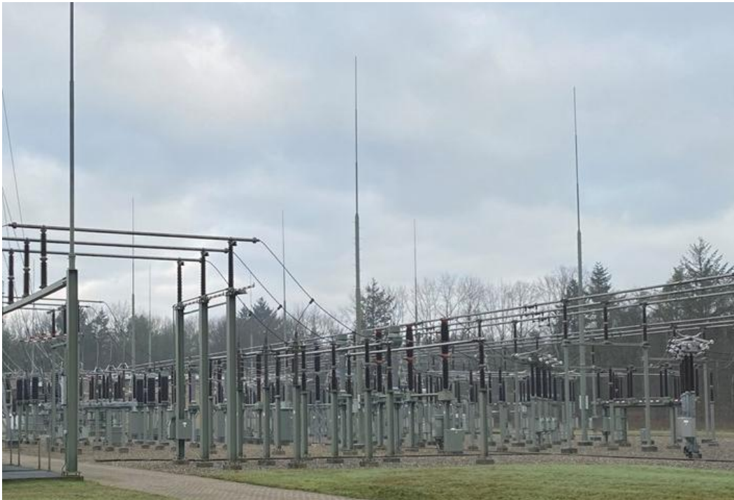
afbeelding 6: voorbeeld van een schakeltuin met bliksempitsen (bron: Liander)
