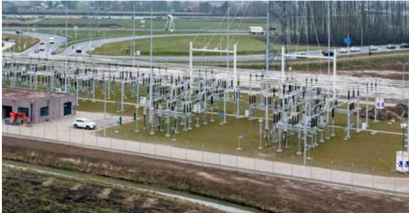
Schakeltuin TenneT met rondweg, bliksemspitsen en portalen.
