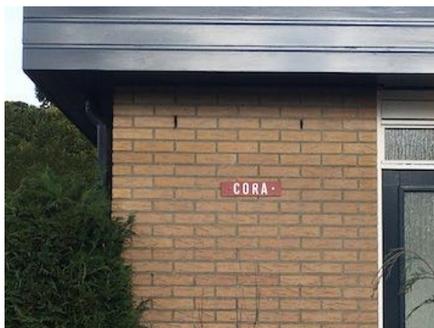
Figuur 14. Open stootvoegen in de gevel van een bungalow aan de westkant als potentiële toegang voor vleermuizen.
