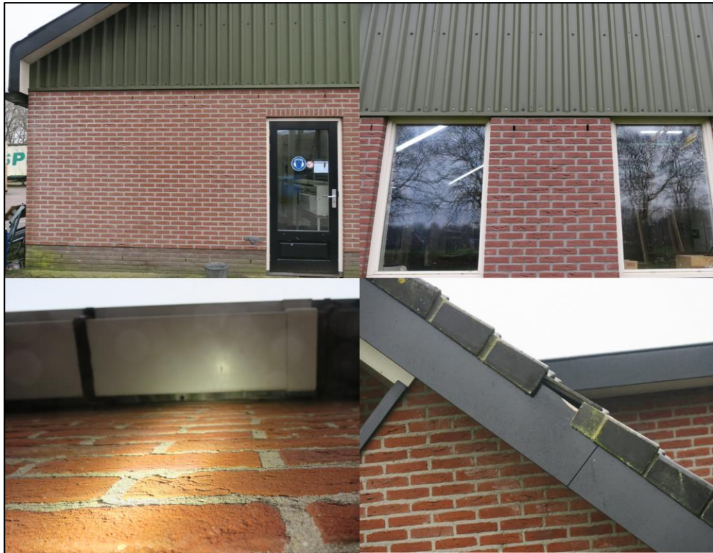
Figuur 3 Openstootvoegen, kierende en ontbrekende kantpanen en niet aansluitende gevels kunnen vleermuizen toegang verlenen tot de open spouwruimte en/of dakruimte.
