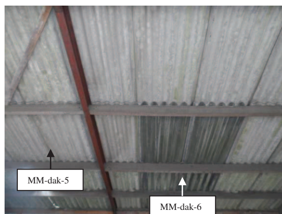
Foto 12: Asbesthoudende golfplaat als dakbedekking van schuur 3 van binnen gezien.
