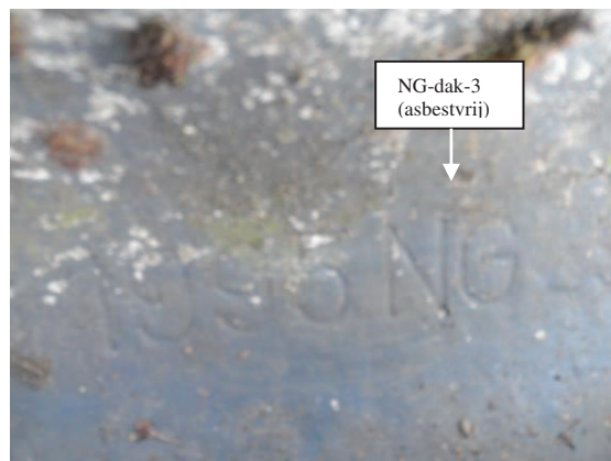
Foto 14: NG-code waargenomen in asbestvrije golfplaat als gedeeltelijke dakbedekking van schuur 3.
