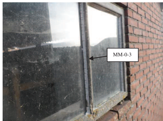
Foto 7: Asbesthoudende stopverf in betonnen raamkozijnen van schuur 2.
