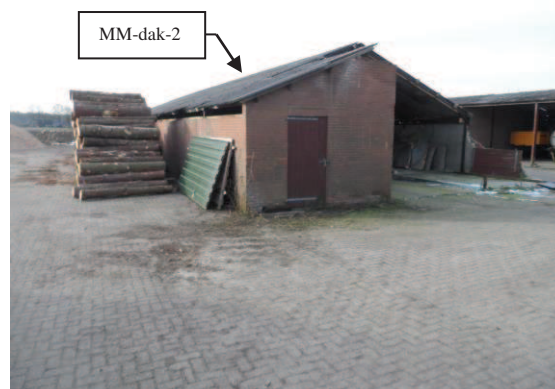
Foto 6: Geïntervieweerde schuur 2 met asbesthoudende golfplaat als dakbedekking vanuit noordwestelijke richting gezien.
