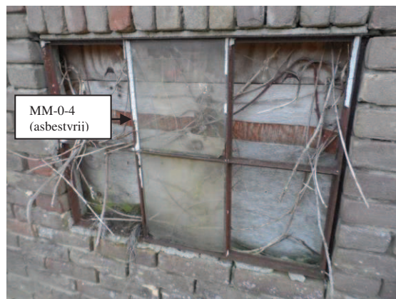
Foto 8: Asbestvrije stopverf in raamkozijnen van schuur 3.
