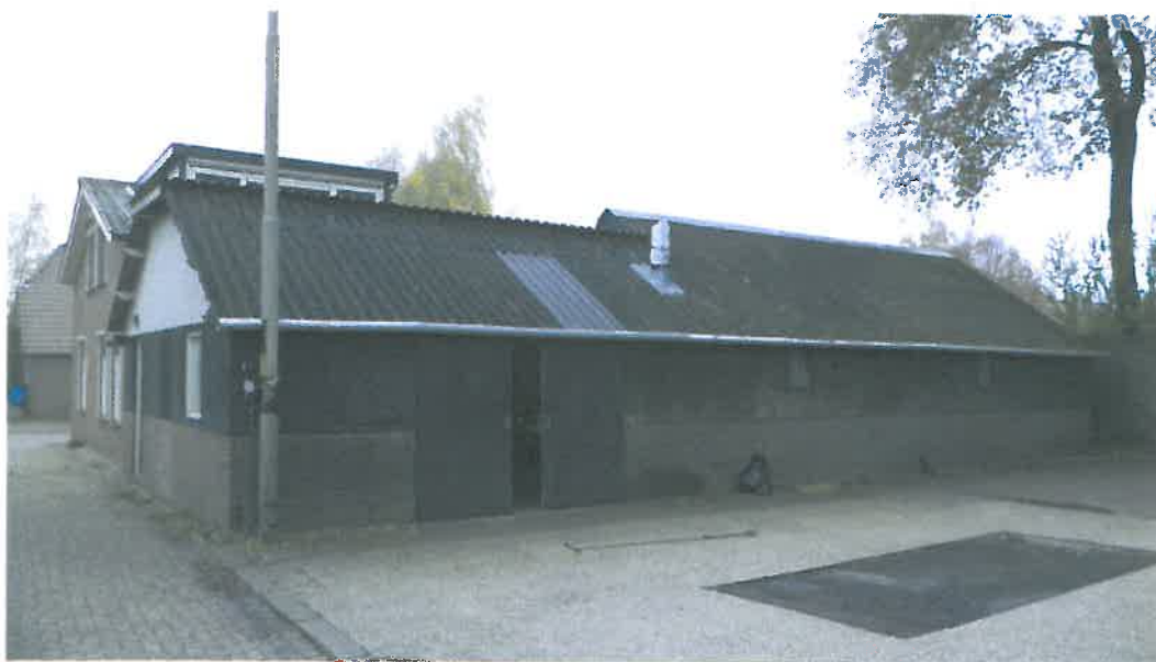
Foto 1: asbest verdachte dakbedekking op bijgebouw
