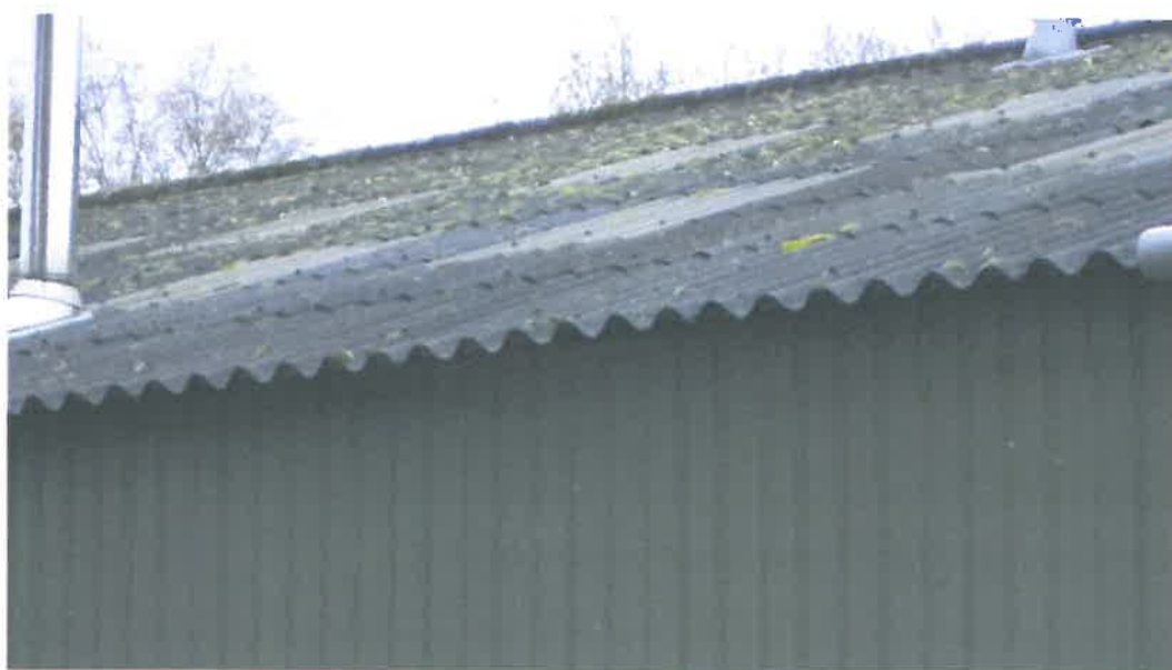
Foto 2: asbest verdachte dakbedekking zonder dakgoot werktuigenschuur
