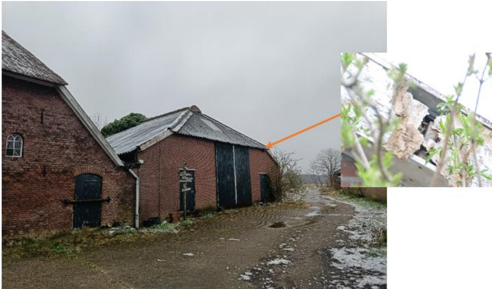
5 Schuur naast boerderij, achter de rotte dakrand zijn vogelnesten aanwezig
