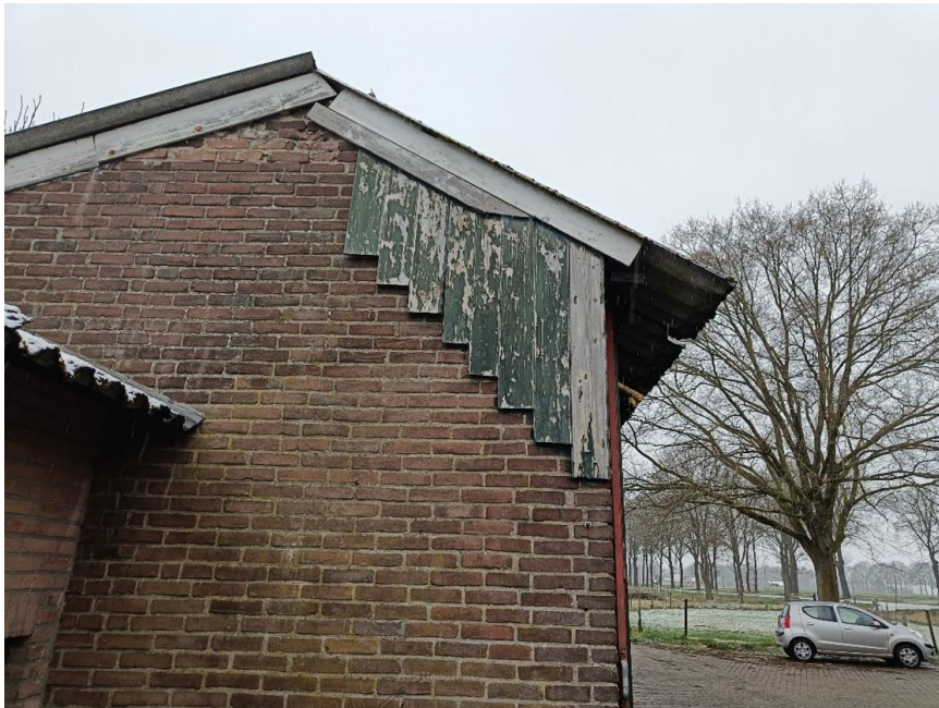
15 Gevelbetimmering vormt geschikte verblijfplaats voor vleermuizen
