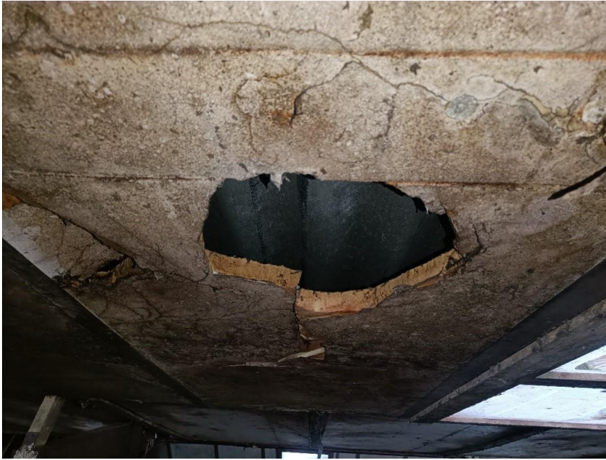
13 Diverse gaten in isolatieplaten zijn geschikte verblijfplaatsen voor steenmarter
