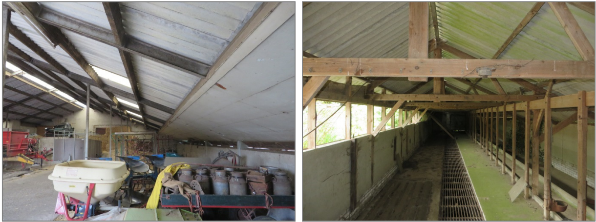
Afbeelding 5.2: Links het deels afgetimmerde dak van de ligboxenstal, rechts de kippenschuur met de aan de binnenzijde met asbestplaten beklede muren en asbestplaten golfdak. Foto's: Natuurkompas, 2017.
