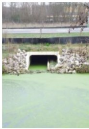
duiker provinciale weg voorzien van loopplank
