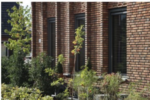
HWA-leidingen geïntegreerd in de gevel
