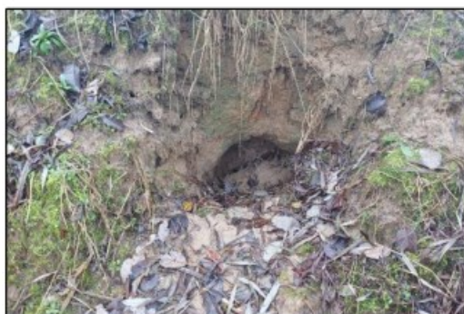
Figuur 2.11. Ingestorte vluchtpijp.
