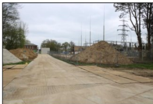
Figuur 4.17. Hoogspanningsstation zuidzijde.
