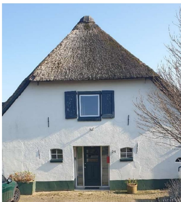
Foto 4: Openingen, spleten, kieren in westgevel
