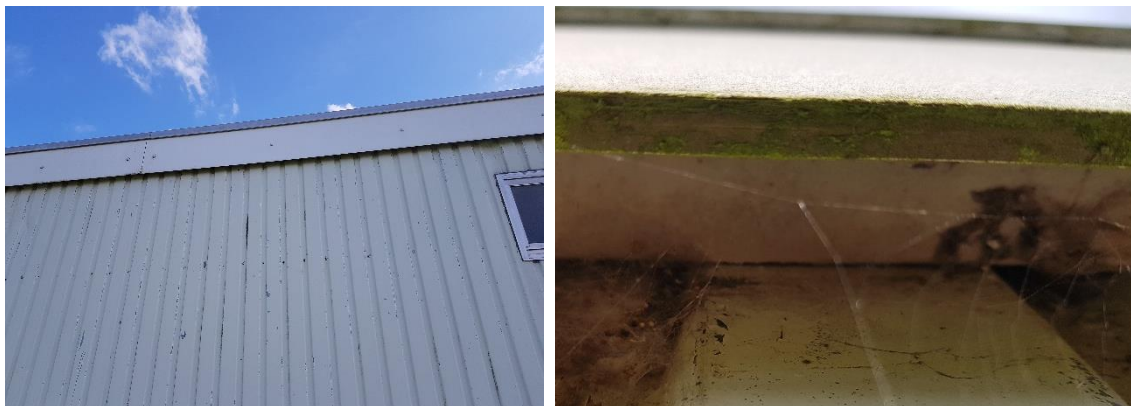
Figuur 10. Spleet aan de dakrand van de werfkeet (links) en een foto waar te zien is dat deze is afgesloten met kunststof (rechts).
